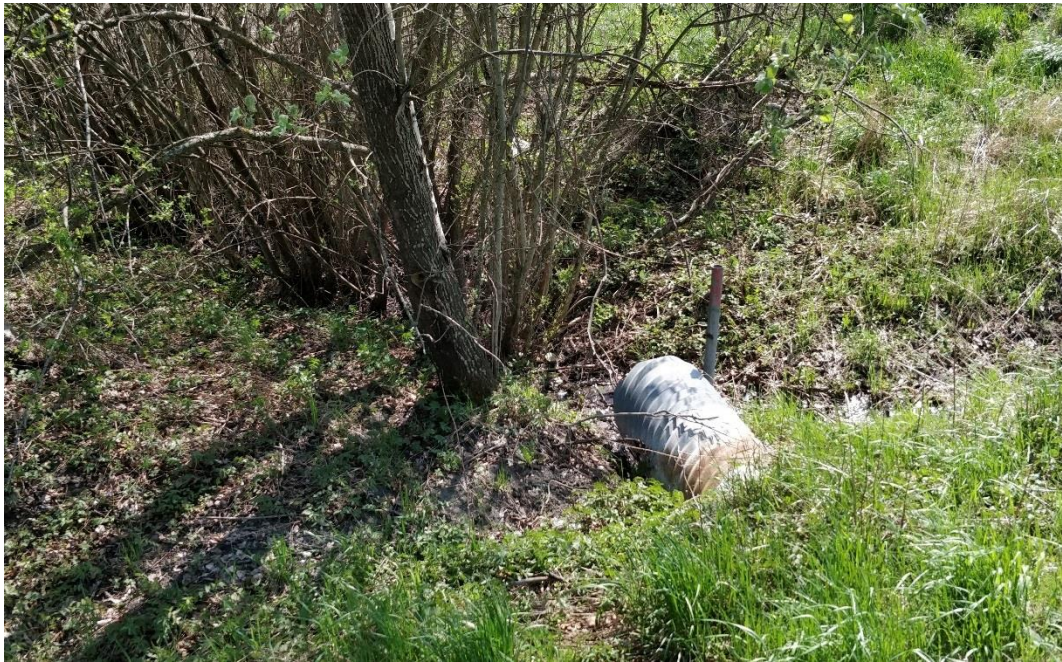
Figur 7: Vägtrumma som går under Björkkällevägen och avvattnar en del av vägområdet och skogen väster om vägen.
