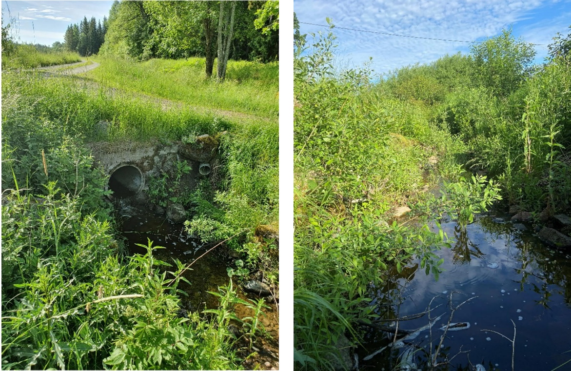
Figur 14. Utlopp från huvudsakligt dikessystem i norra delen av planområdet. Trumma med dimension på ca 600 mm.
